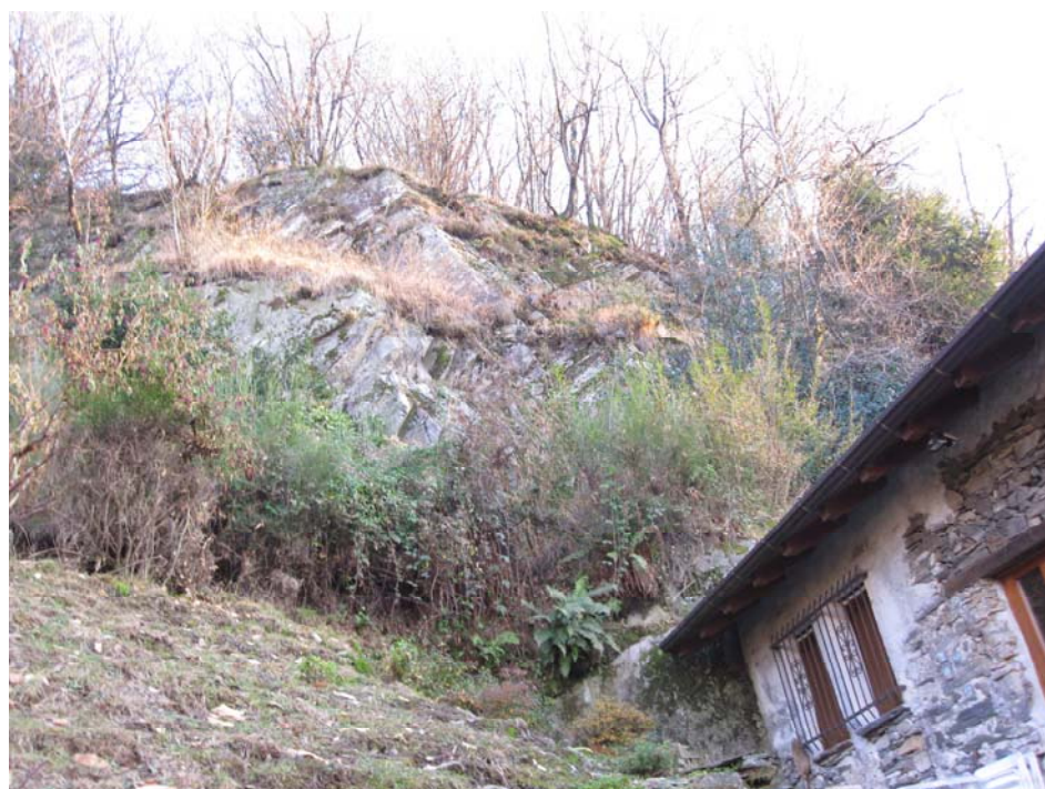
Fotografia 1: Parete possibile origine di crolli vista da nord-ovest.
