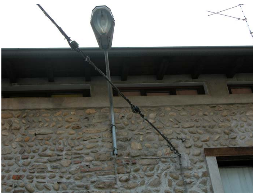
Giunzioni di cavi su facciata in Via Angolare
