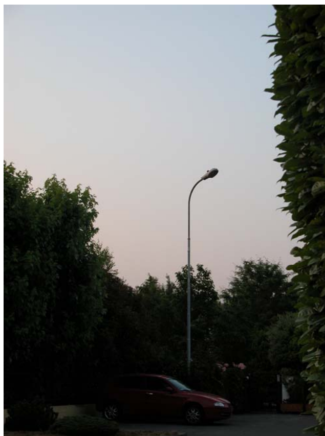
Via Don Greppi: linea interrata
