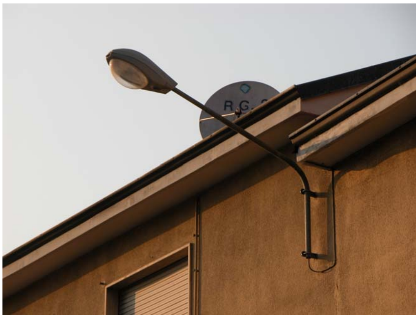
Via Principale: armatura stradale chiusa mediante coppa prismatica non rispondente alla L.R. 17/2000
