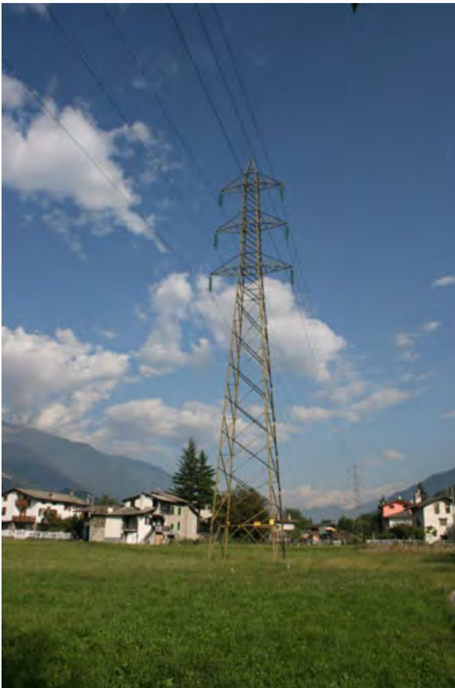
Elettrodotto in contrada Piano
