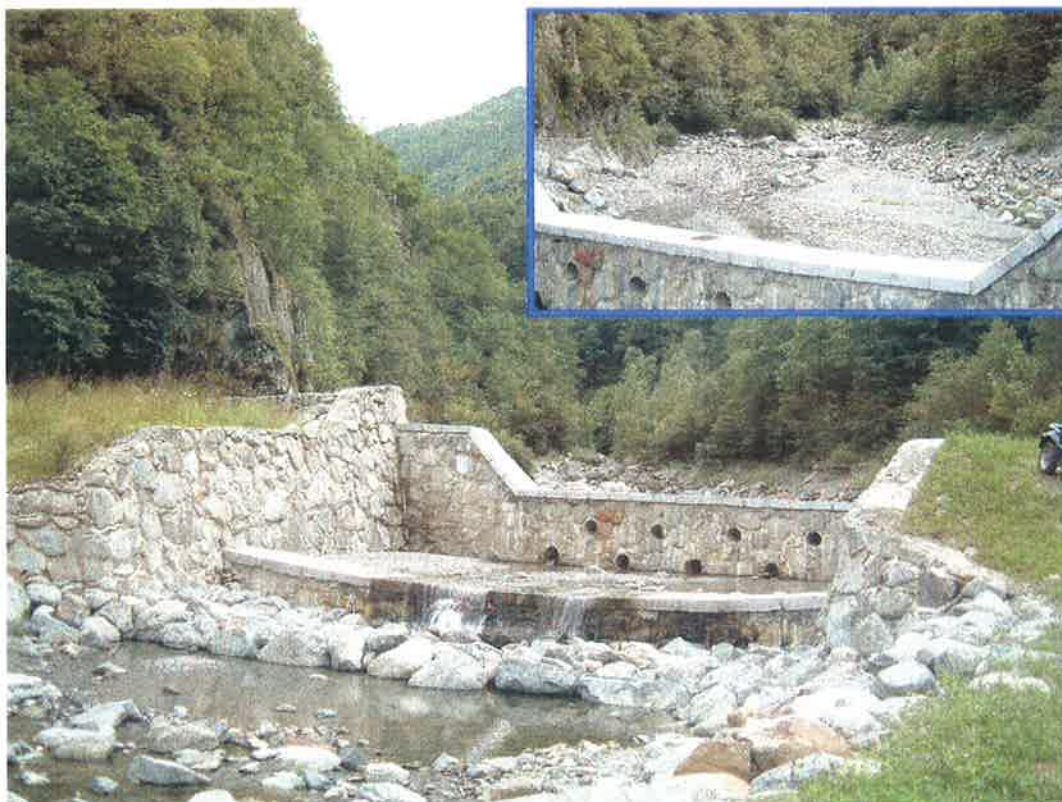
Foto 6 Briglia posizionata all'apice della conoide che crea a monte una vasca di espansione di oltre 30000 metri cubi; nel riquadro una visuale della vasca.
