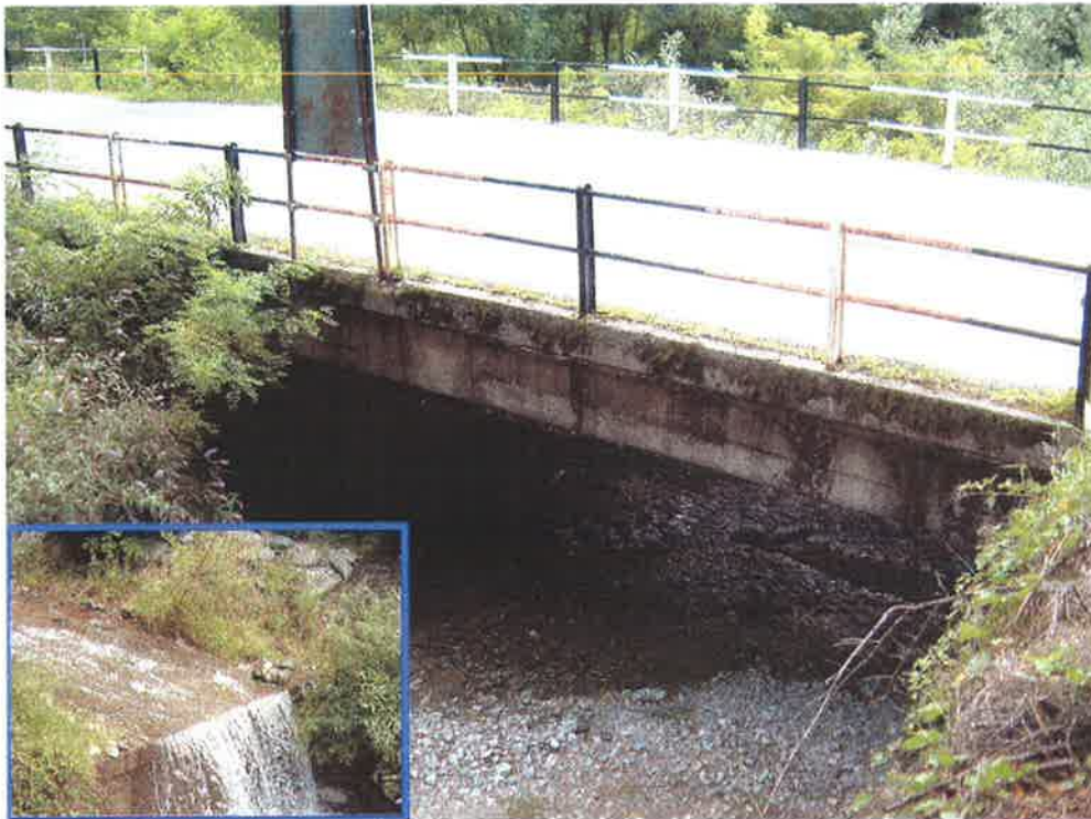
Foto 2 Ponte a quota 517 m slm nella zona mediana della conoide; nel riquadro una briglia subito a monte del ponte.
